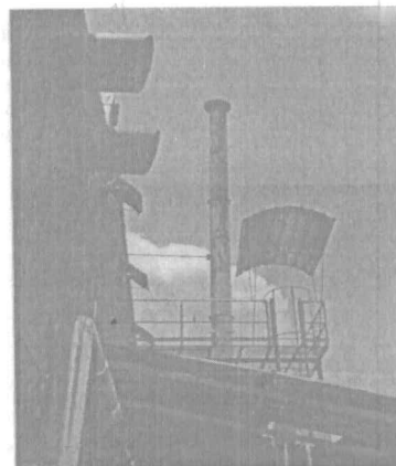
Foto 5. Chimenea de la caldera de vapor.
