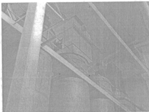
Foto 2. Silos de almacenamiento de material procesado con dos filtros mangas en la parte superior.
